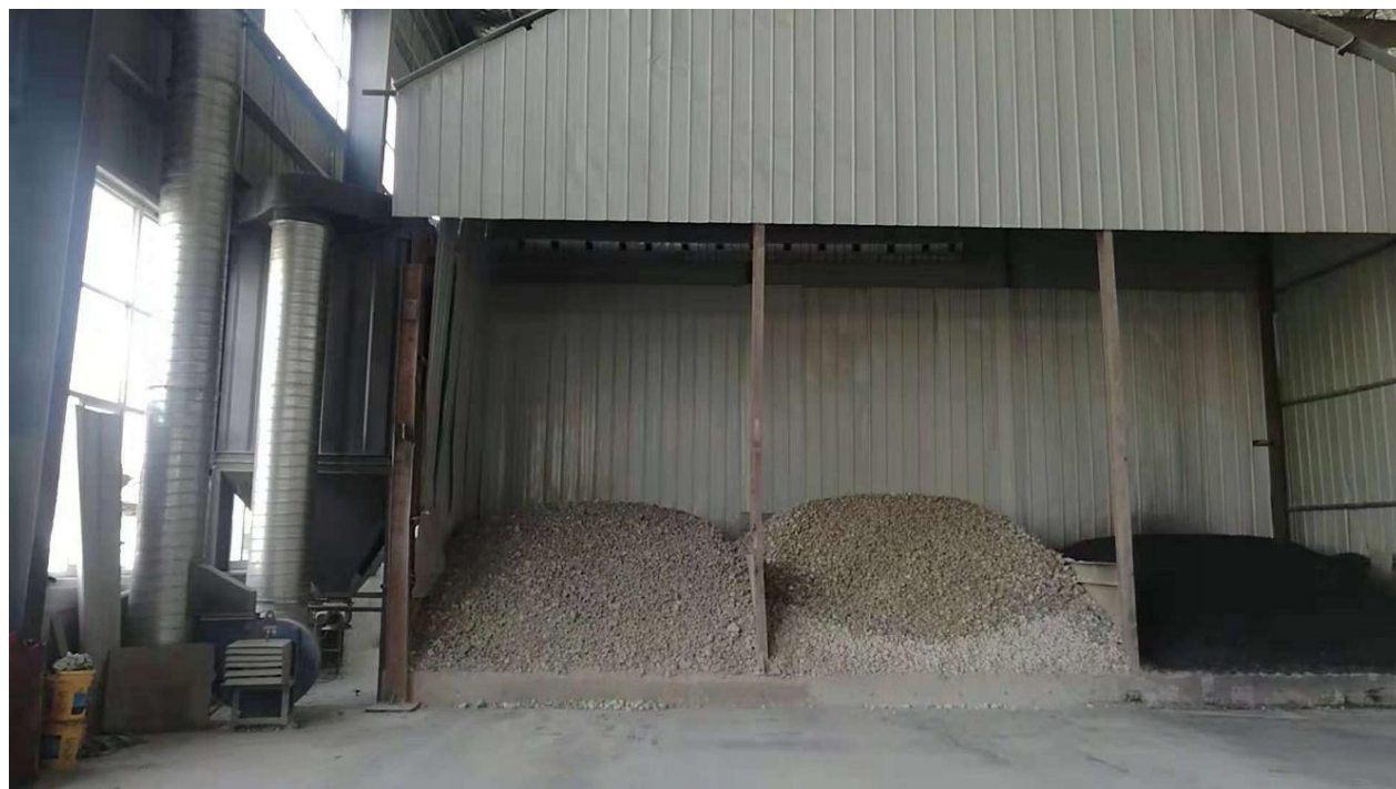
上料除尘器及排气筒
