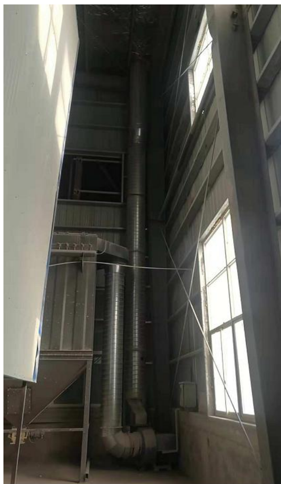
落料除尘器及排气筒
