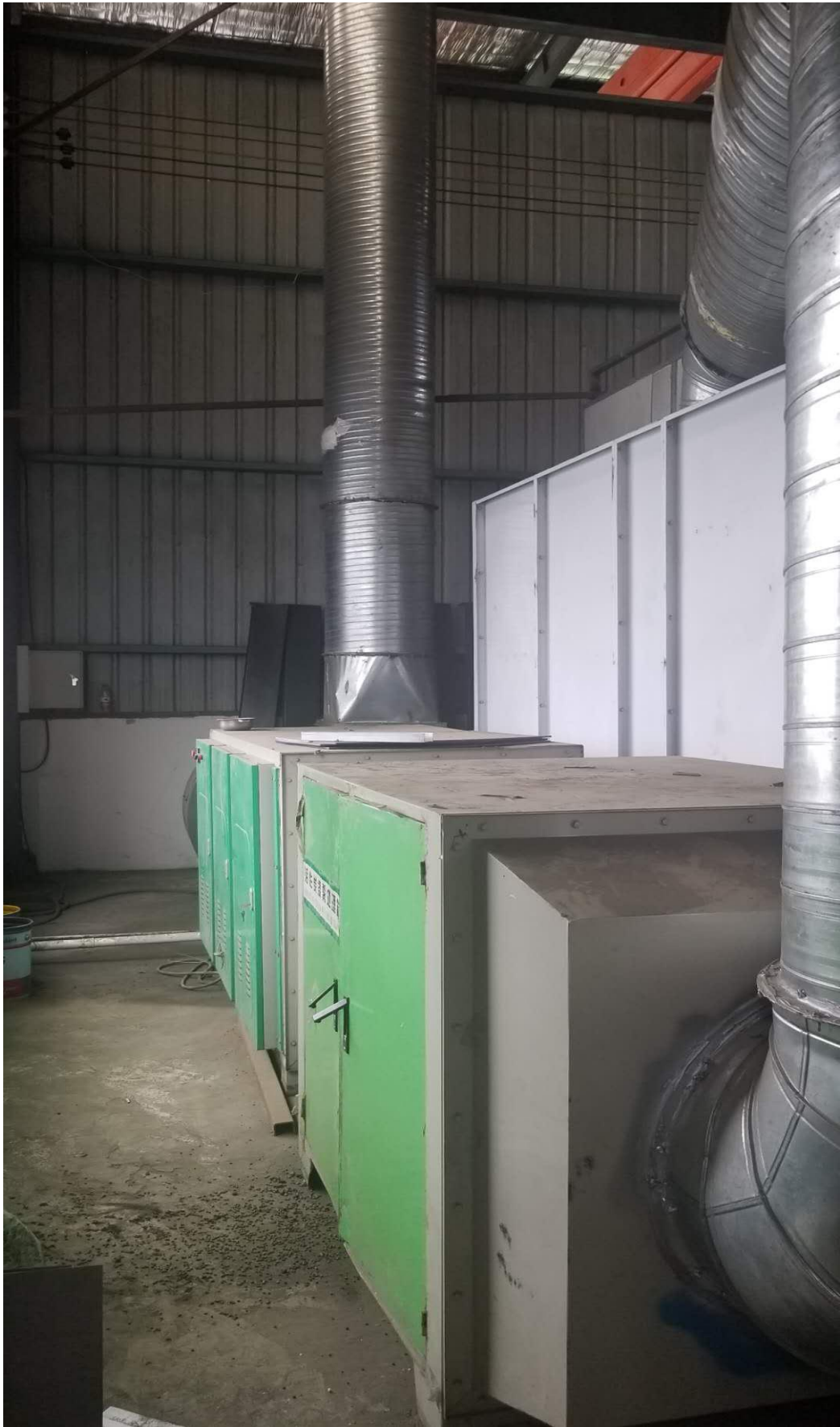
吸附棉过滤+活性炭吸附+光氧催化装置
