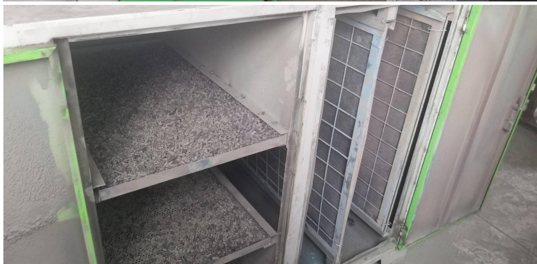
吸附棉过滤+活性炭吸附+光氧催化装置
