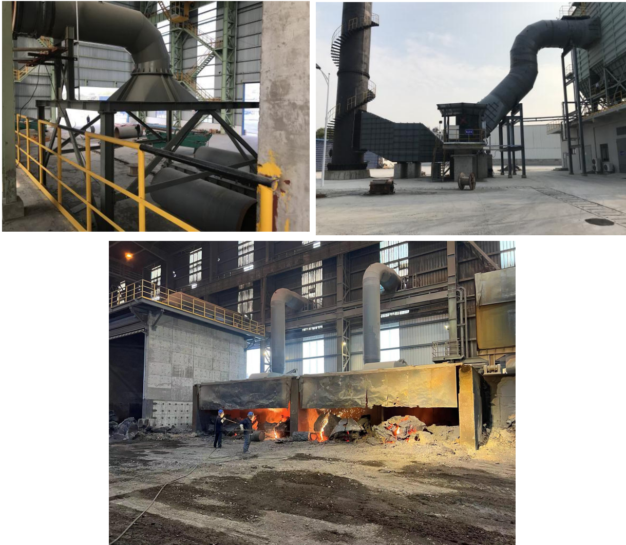
图5-1 生产车间设置的除尘设施
